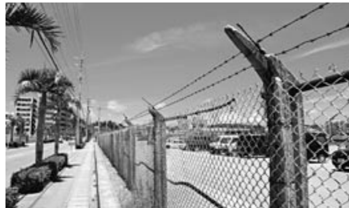
フェンスの改修が必要な浜川漁港
